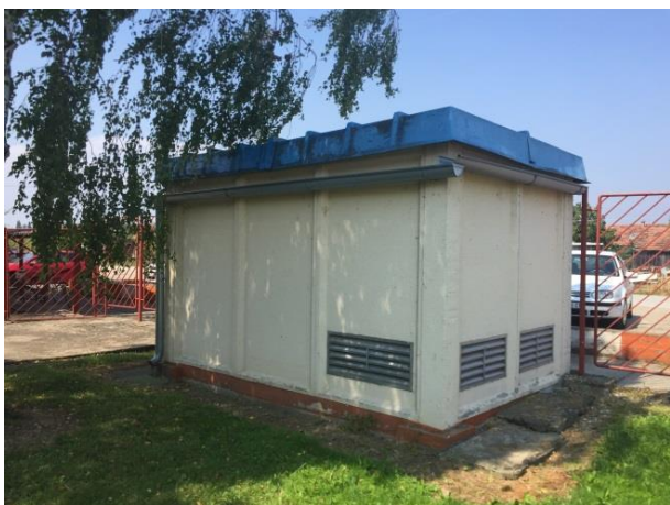
Zgrada br.8 – Trafo stanica
