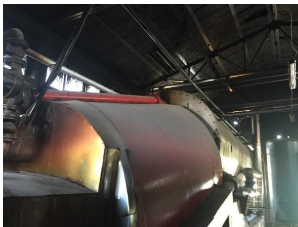
Zgrada br.6 - Kotlarnica
